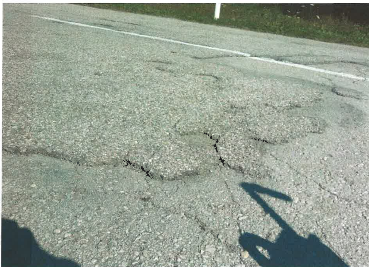
Slika 9: Stanje obstoječega vozišča pri stacionaži 8.500 m – odpadanje asfalta.
