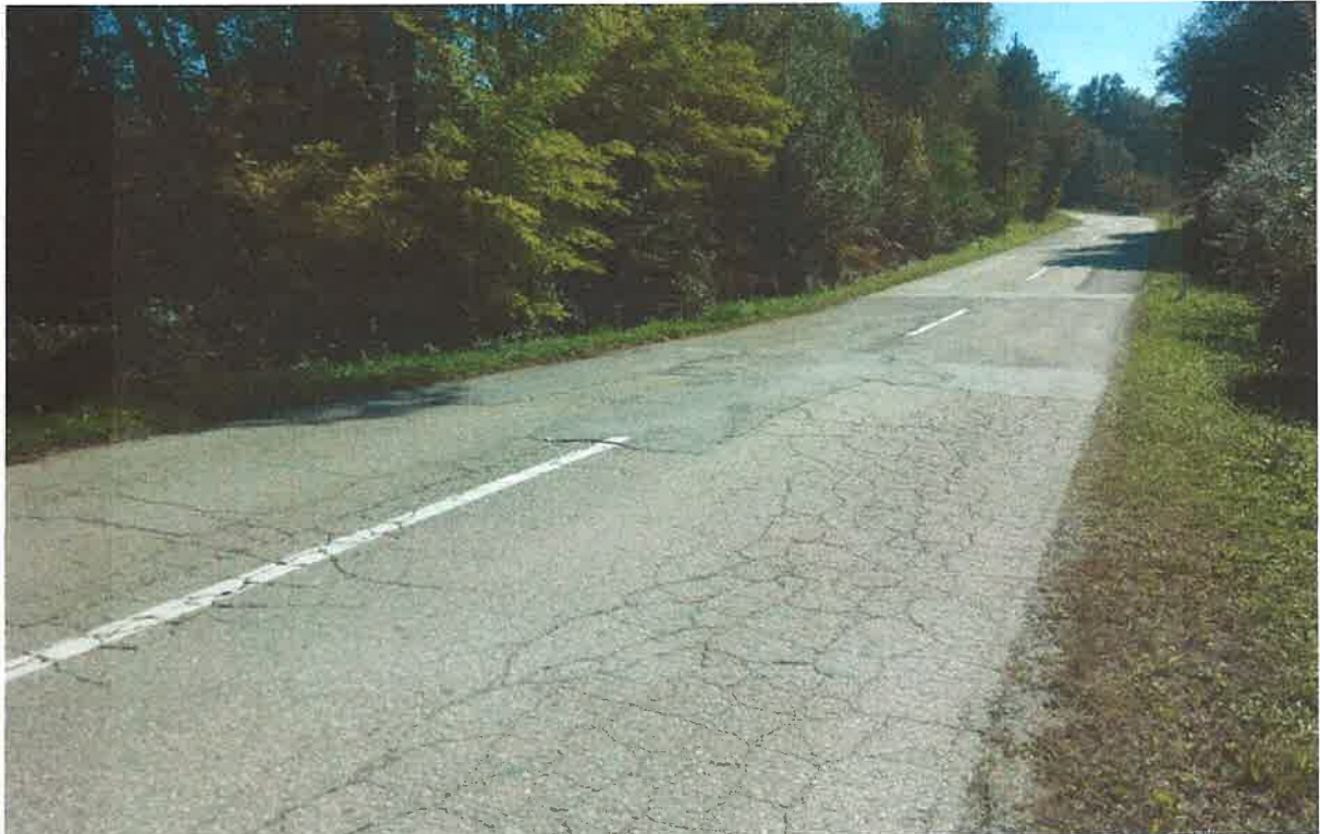
Slika 6: Stanje obstoječega vozišča pri stacionaži 7.830 km - vidne mrežaste razpoke.
