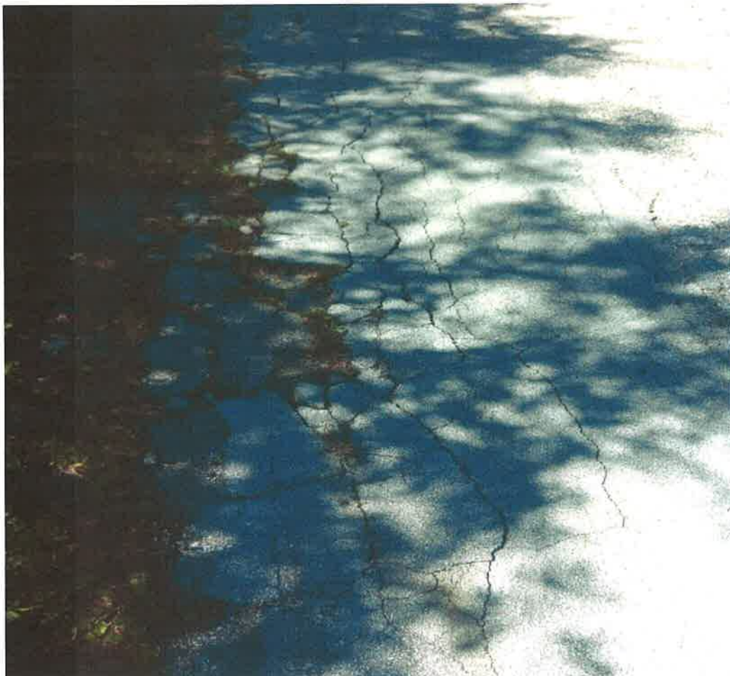
Slika 7: Stanje obstoječega vozišča - drobljenje asfalta.
