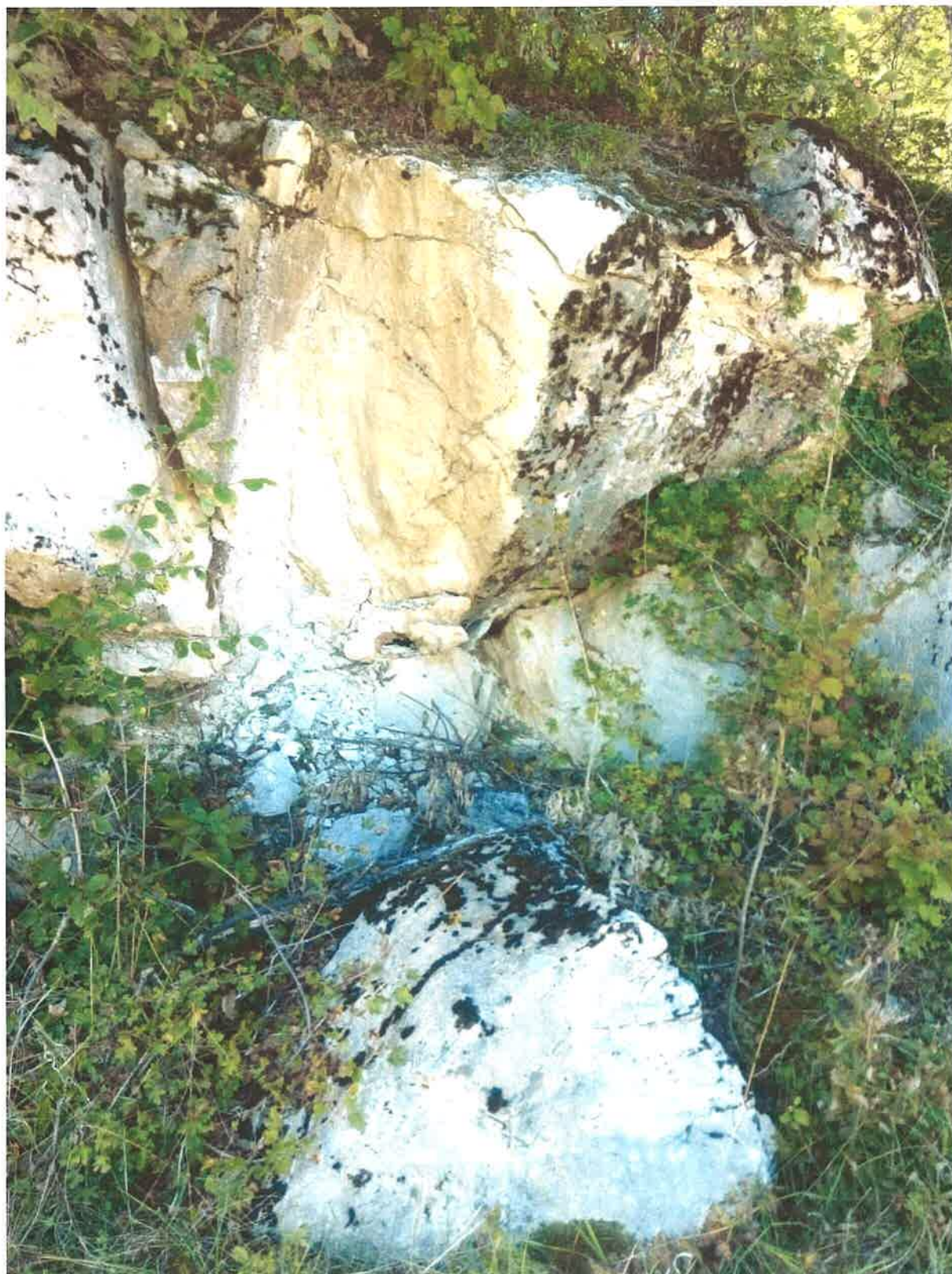
Slika 8: Potrebna zaščita brežine, pri stacionaži 7.550 m.
